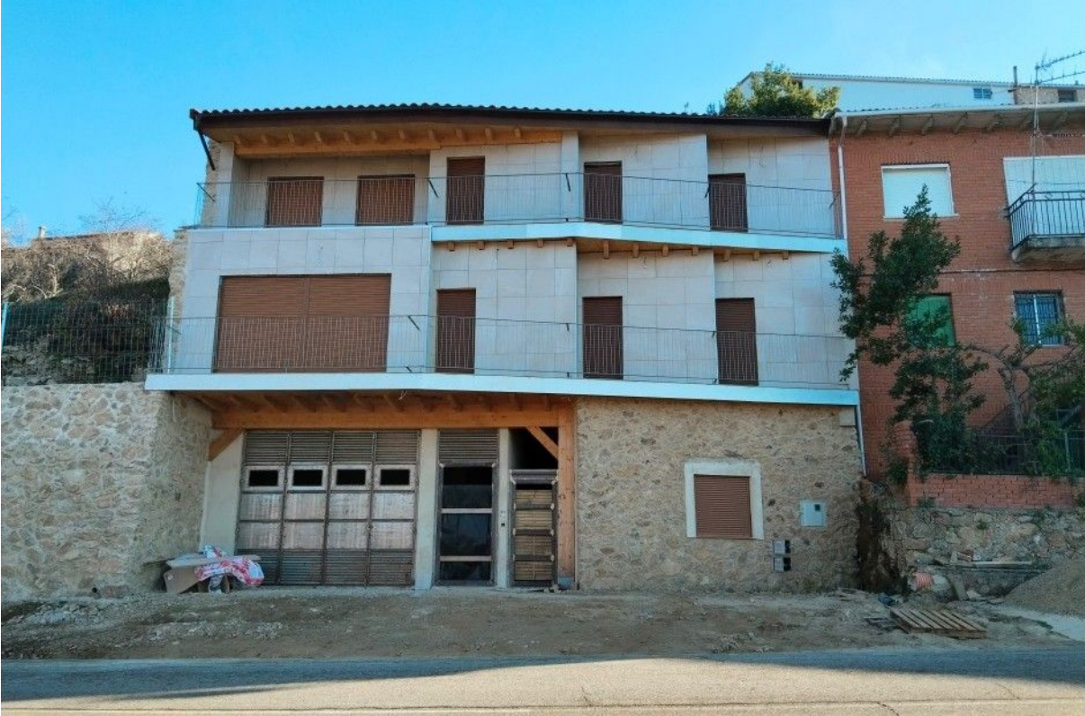
Ilustración 4: Fachada oeste afectada por la alineación
